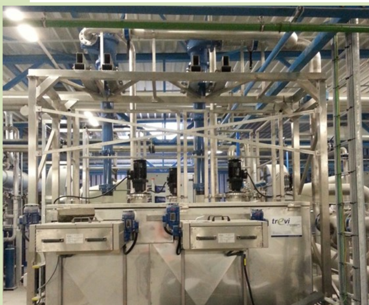
Hydrocyclone et table d'épaississement
