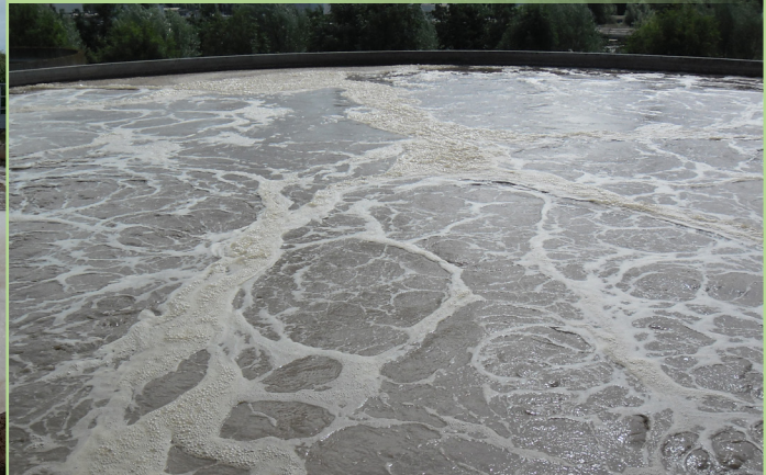
Nouveau système d'aération
