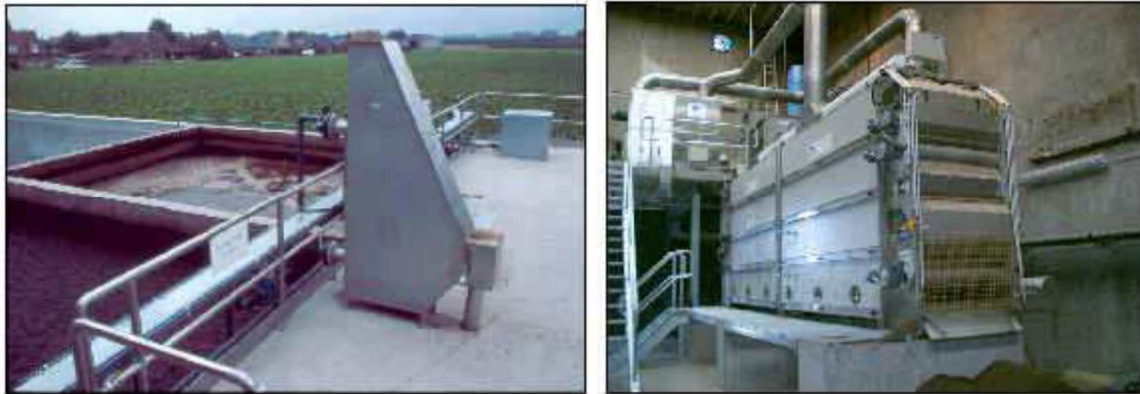
Figuur 1. Biologische zuiveringsinstallatie voor de dunne fractie (links) en condensatiedroging voor de dikke fractie (rechts), beide volgens de Trevi-technologie
